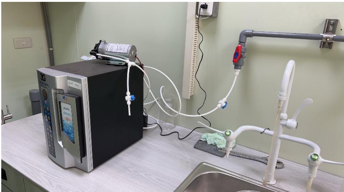
圖2 供壓系統連接濾（淨）水器商品(照片來源：本局臺南分局)
