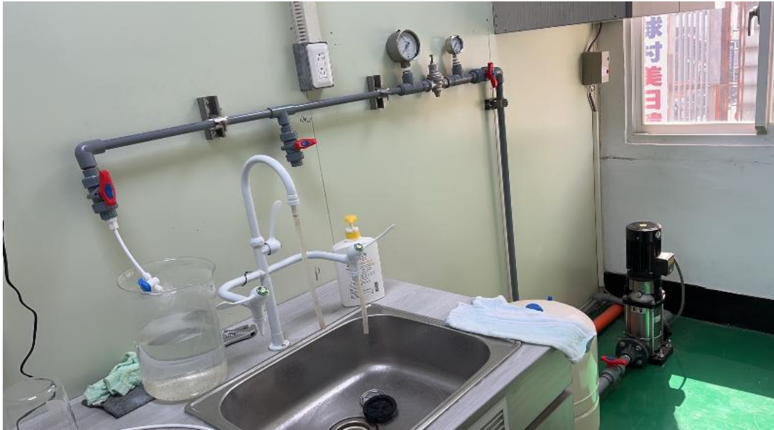
圖1 供壓系統(照片來源：本局臺南分局)
