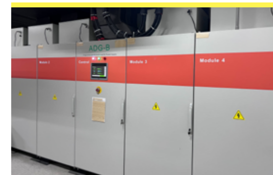
< 1 MW 電池模擬器設備
