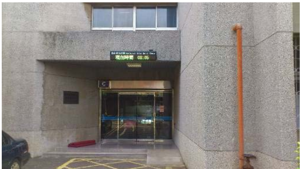
圖 2.5-7：低頻簡易型看板安裝在中華電信研究所 C 棟門口實景
