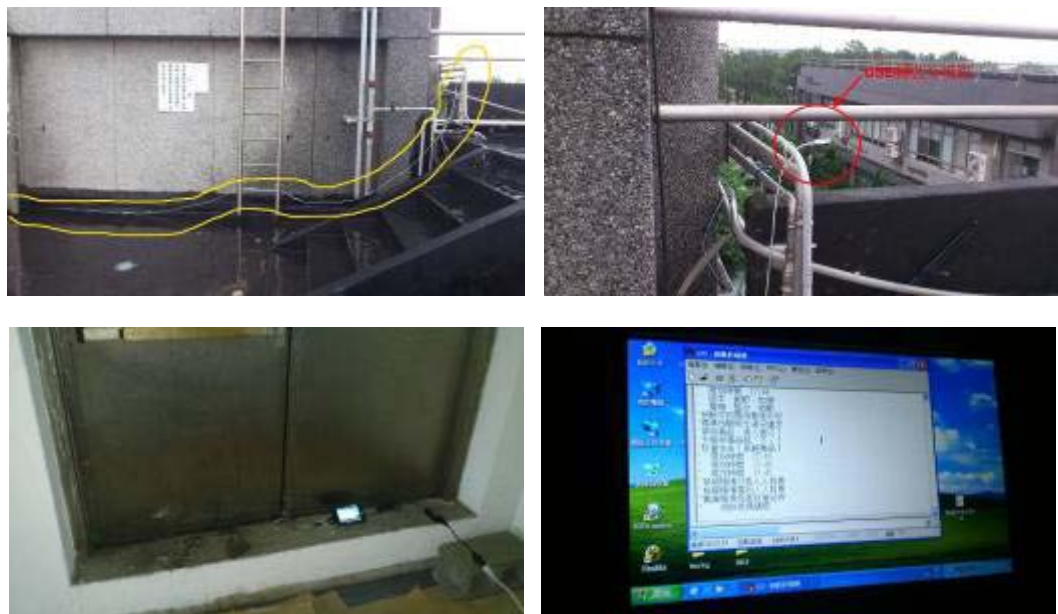
圖 2.5-8：藍牙低頻接收解決方案安裝在中華電信研究所 C 棟頂樓
