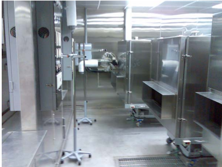
圖 38：71kW 空調機實驗室室內側
