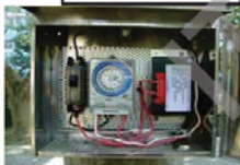
光明新村PLC加裝中繼器
