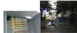
民生變電所內FTU 送至北區營業處
