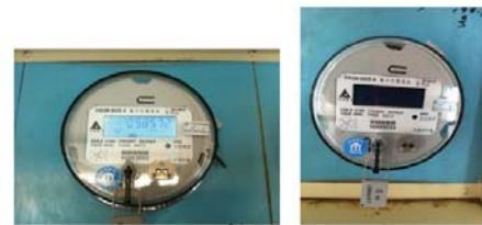
數位電電表故障狀況
