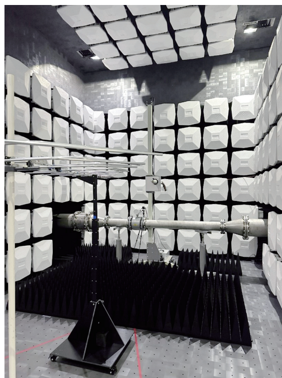
圖5 電波暗室實流檢測實驗室
